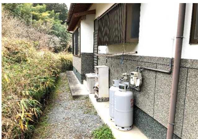
プロパンガス施設
