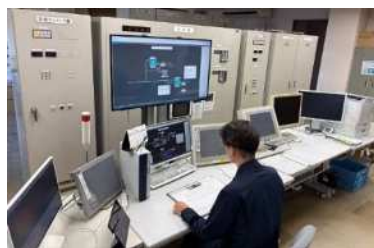
①上野浄水場での運転操作
